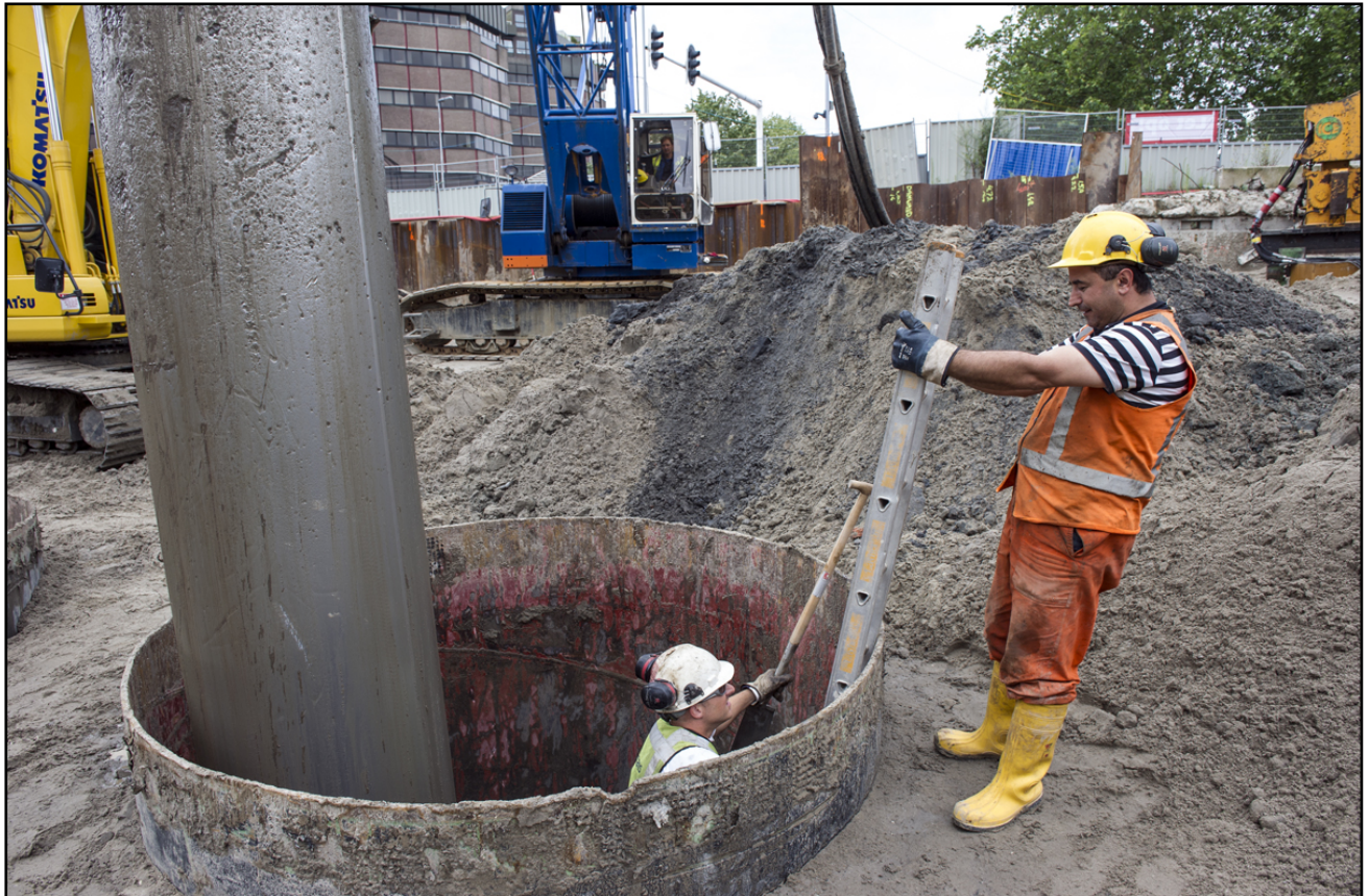
Verwijderen van funderingspalen van de voormalige Catharijnebak, ter hoogte van het Vredenburg
