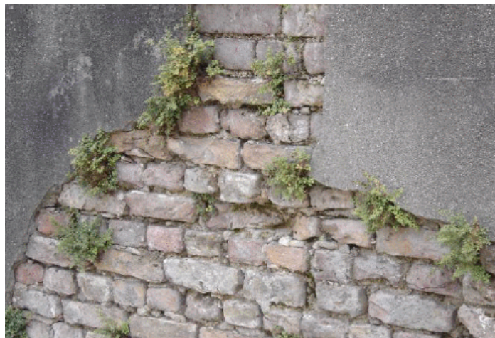
Afb 10 scheuren in de muur
