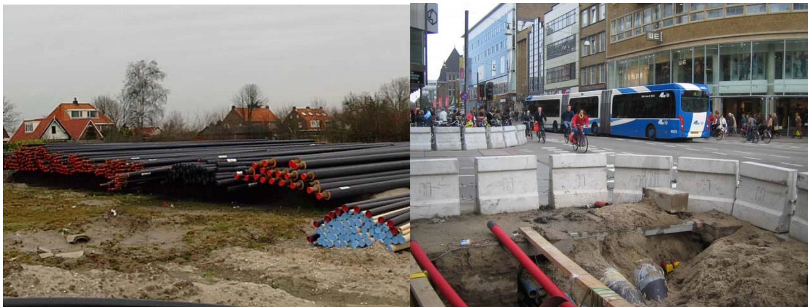
Fig. 29: stadsverwarmingsbuizen en stadsverwarming Vredenburg
