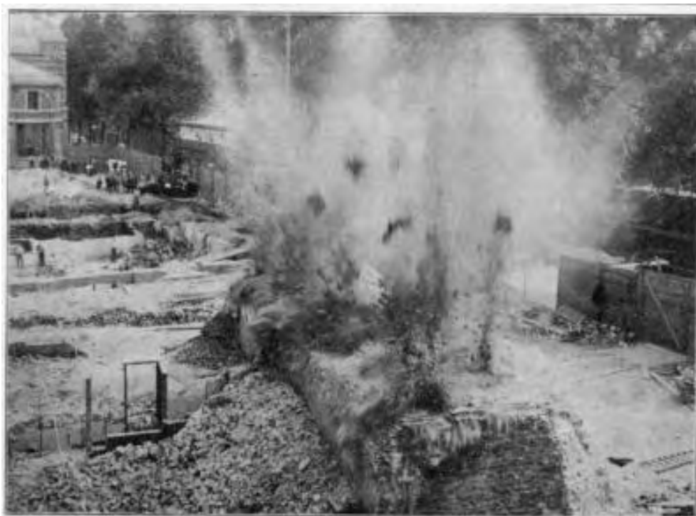
HET GEREEDMAKEN VAN HET TERREIN VOOR DEN BOUW VAN EEN EERSTE VAST JAARBEURSGEBOUW TE UTRECHT Een oude muur van het voormalige kasteel Vredenburg wordt met dynamiet geamoveerd
