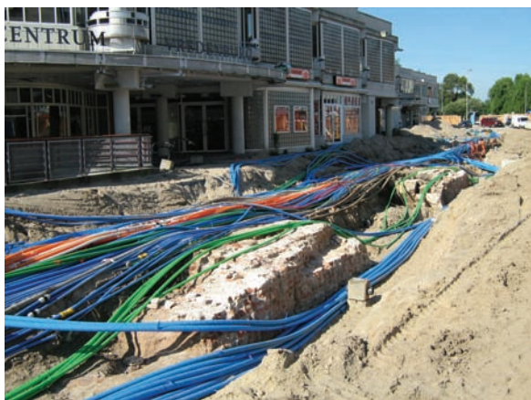
Fig. 5.1.1: in juli 2007 heeft KPN letterlijk honderden kabels en leidingen gelegd langs Muziekcentrum Vredenburg.
